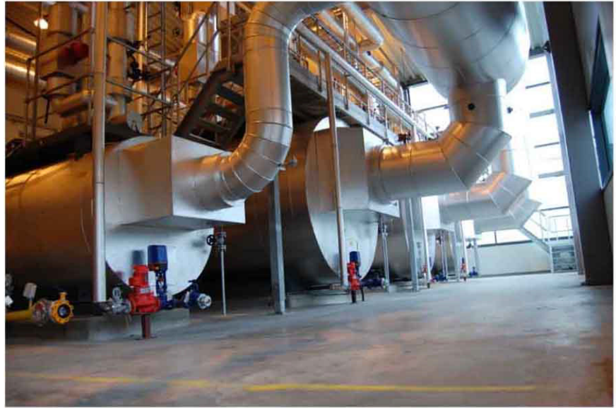
Bildet er fra energisentral nord i Lillestrøm. Foto: Akershus Energi Varme
