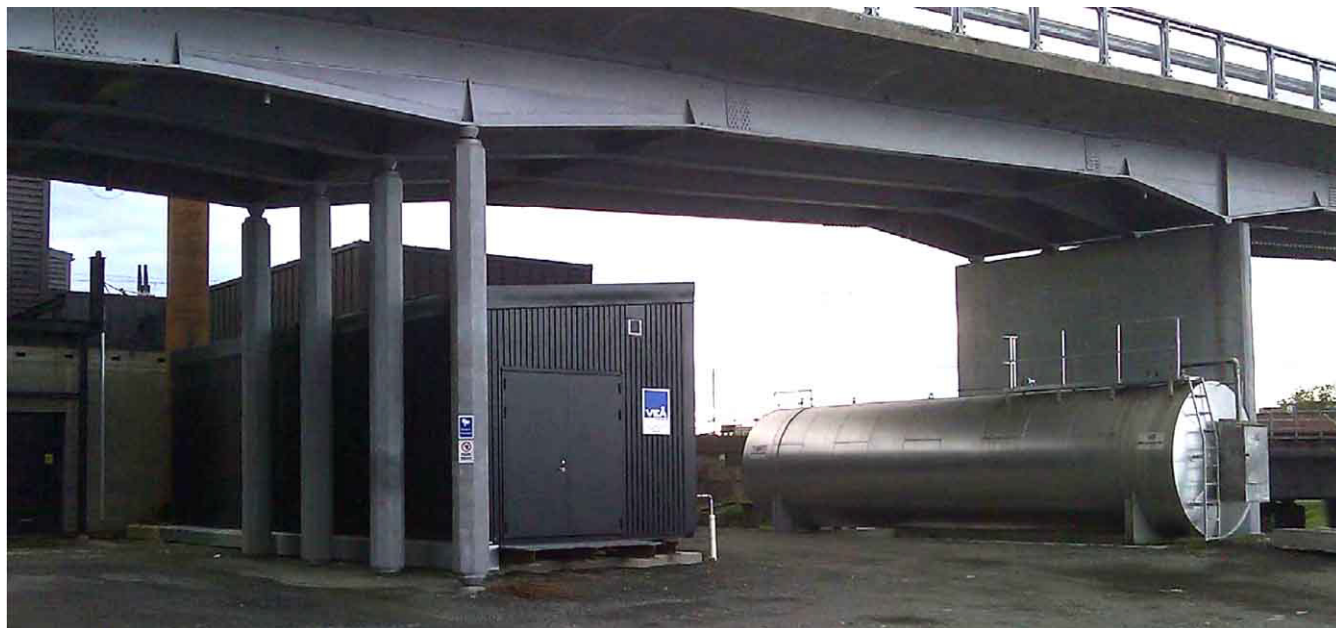
50 m 3 isolert oljetank ved energisentral syd i Lillestrøm. Foto: Akershus Energi Varme
